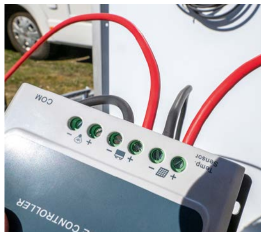
6 På kontrollenheten finns anslutning för ström in från solpanelen och ström ut till batteriet samt extern strömförbrukare. Här kan även en temperatursensor och en extern panel anslutas.
